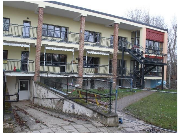
Gebäude C, Trockenlegung dringend erforderlich
