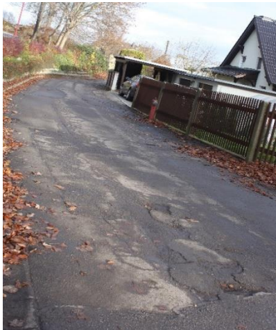
Sanierungsbedürftiger Oberer Gutsweg
